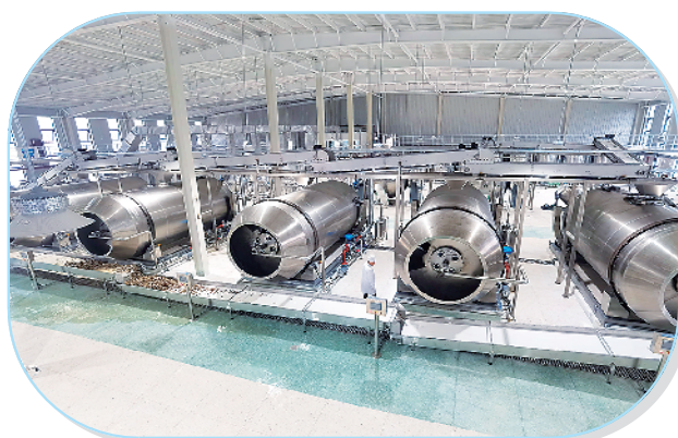
河南省四方药业集团有限公司年产500吨骨胶智能生产线项目。
